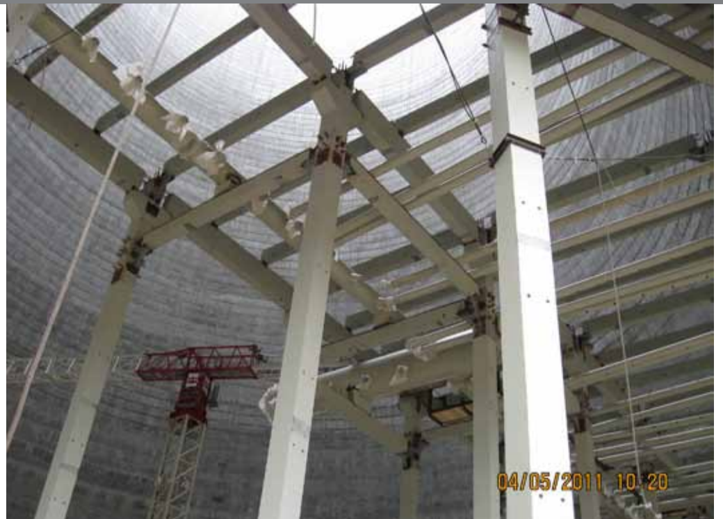
Опоры и трубы водораспределительной системы внутри башни. Фото СПБЭП.
